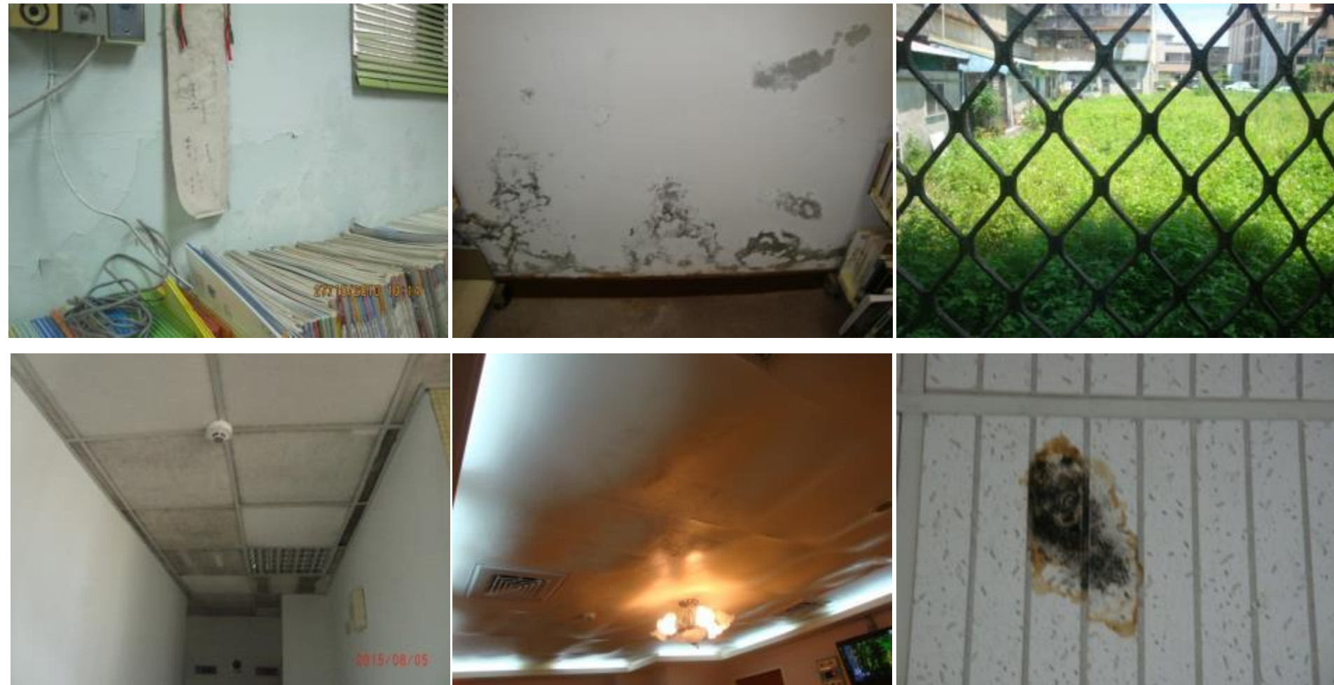
圖3.13 室內潮濕與漏水現象
