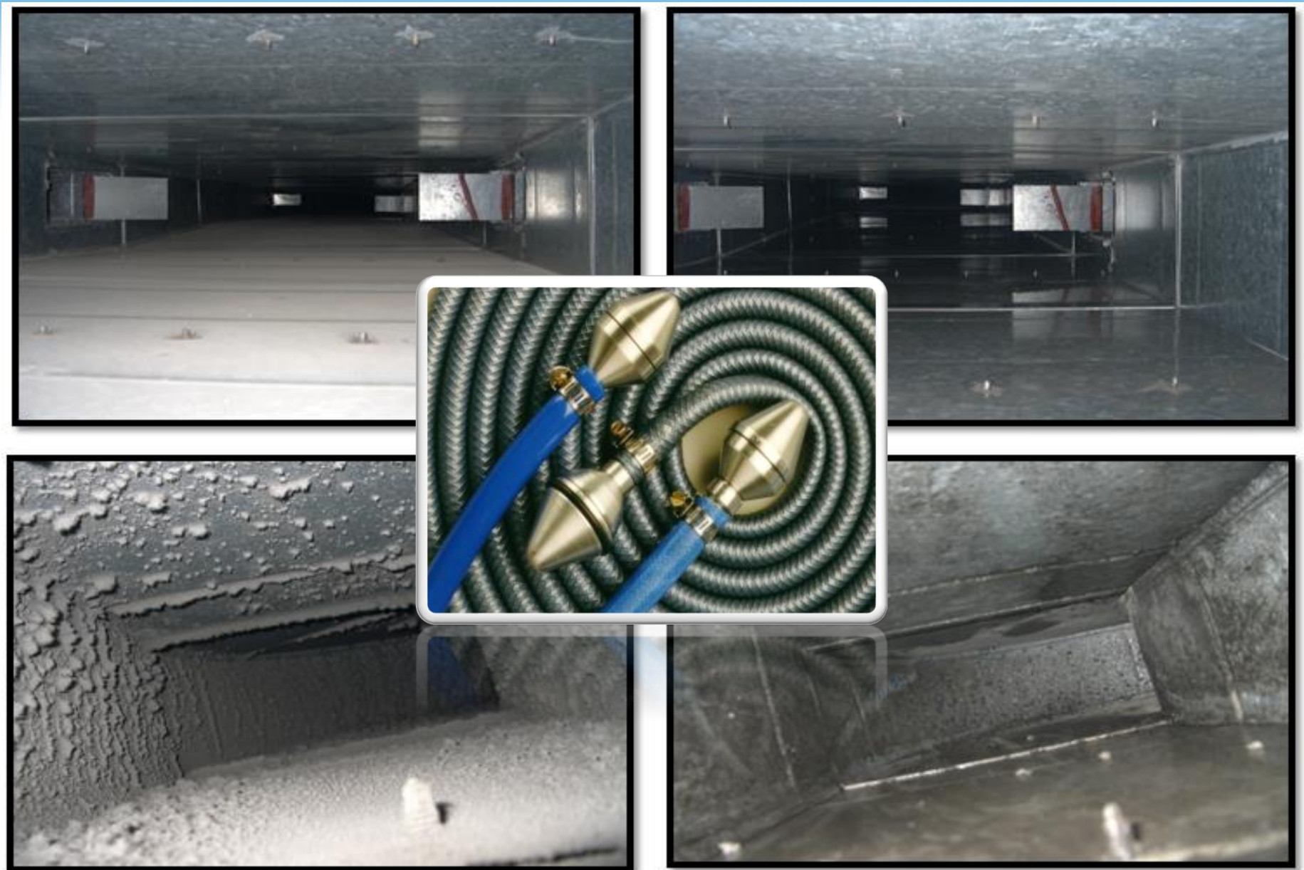
圖6.15 中央空調系統風管內部風刀清潔技術
